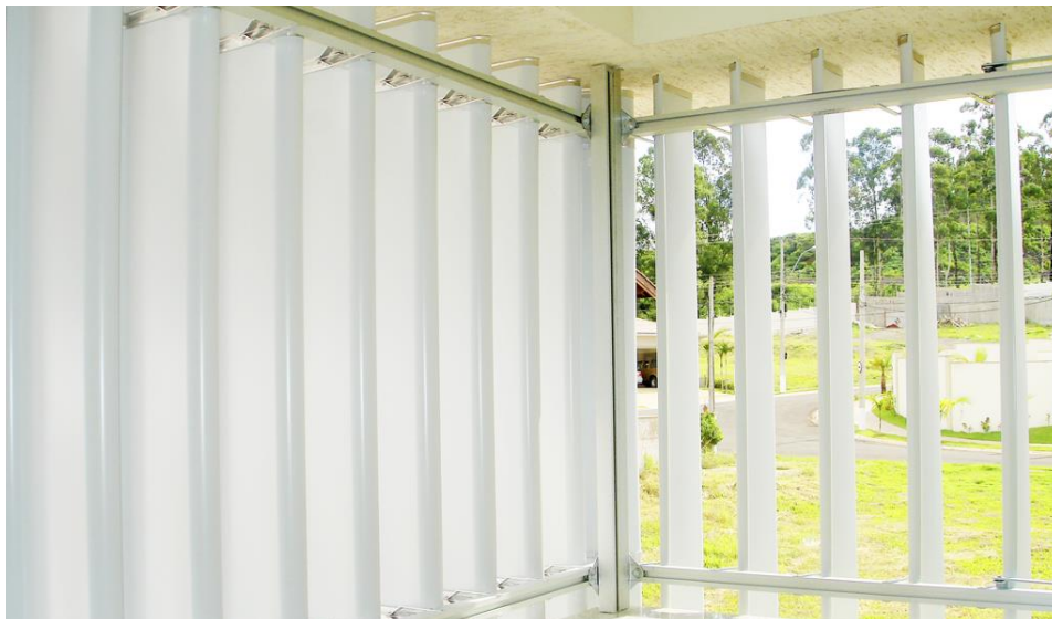
Figura 46 - brise móvel vertical em alumínio branco
