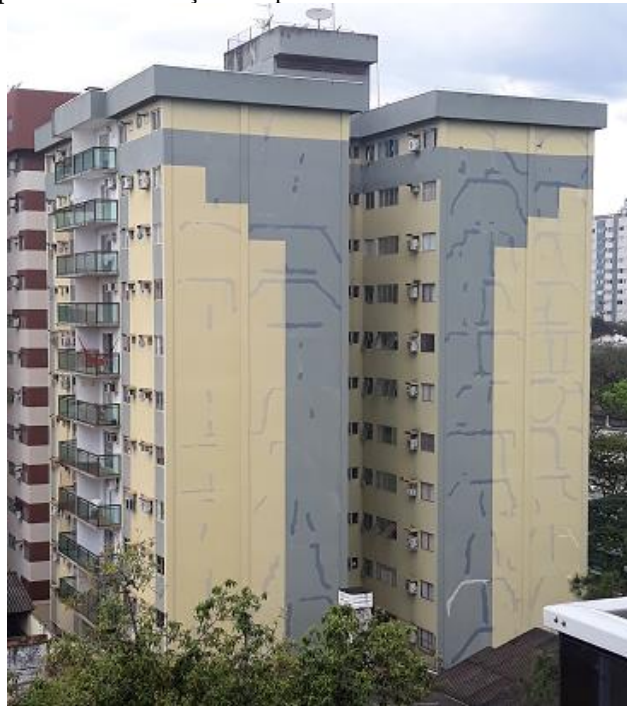
Figura 33 – Exemplo real de fissuração dos painéis de alvenaria em edifício de concreto armado.
