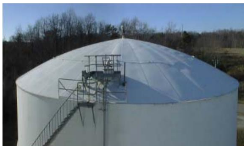
Figura 3 – Tanque de armazenamento com teto em gomos.
