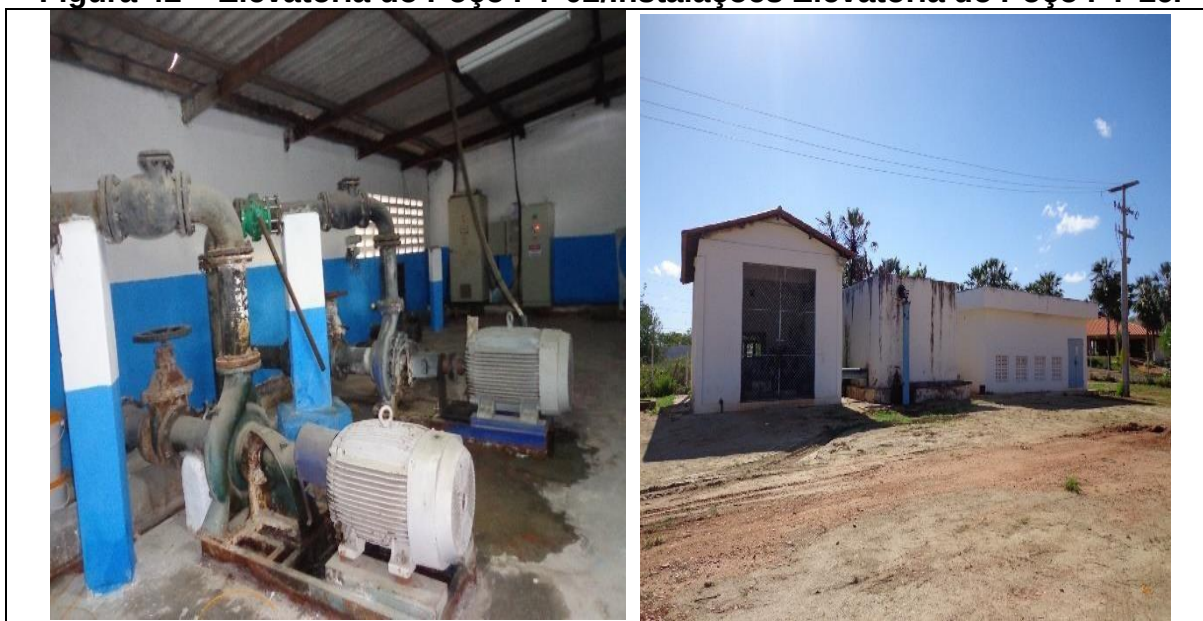
Figura 42 – Elevatória do Poço PT-02/Instalações Elevatória do Poço PT-26.
