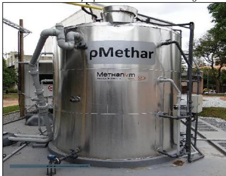
Figura 15 - Reator de metanização para tratamento de resíduos orgânicos da UFMG
