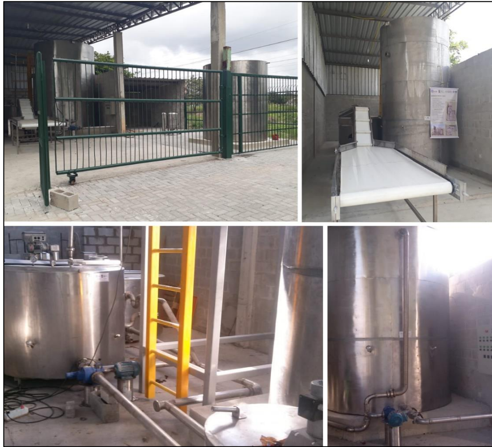
Figura 34 - Sistema de biodigestão anaeróbia em escala piloto instalado no CEASA/PE - Recife utilizado na pesquisa (fotos após a instalação)
