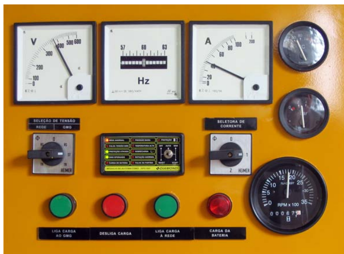
Figura 2.2 – Quadro do comando do grupo gerador
