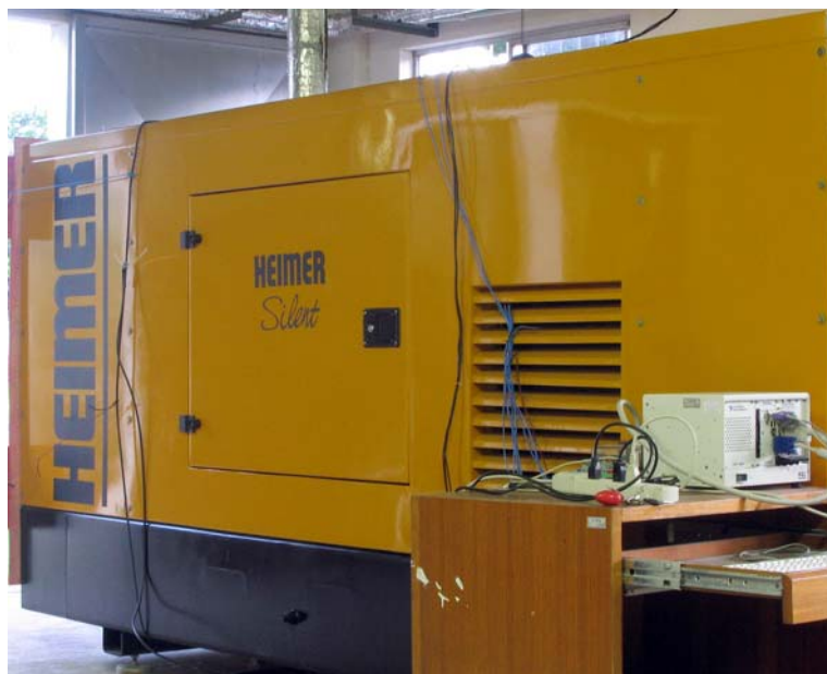
Figura 2.1 – Grupo gerador utilizado nos ensaios
