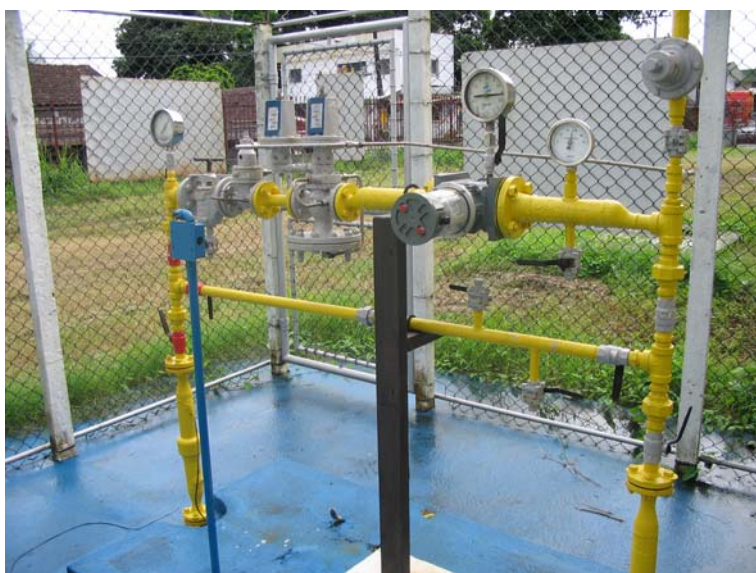
Figura 3.14 – Estação redutora de pressão
