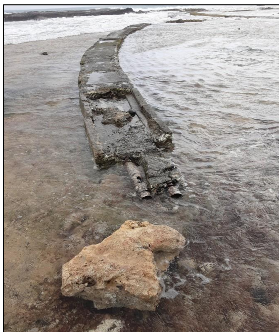
Figura 70 – Duto de PVC com proteção de alvenaria em ambiente de praia. Praia do Boldró. Foto: O autor, 2021.
