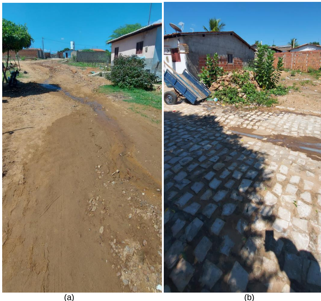
Figura 16 - (a e b) Ruas sem calçamento e esgoto a céu aberto no Bairro Manoel Deodato.
