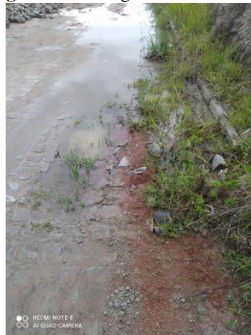
Figura 7 - Patologia 5: Trilha de roda
