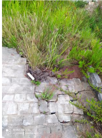
Figura 6 - Patologia 4: Erosão e trinca em bloco
