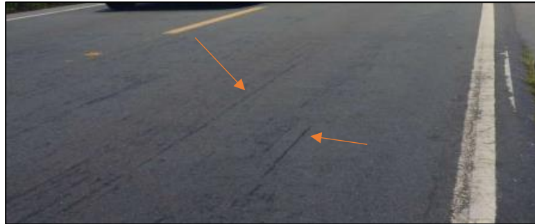
Figura 7 - Fissuras longitudinais no pavimento
