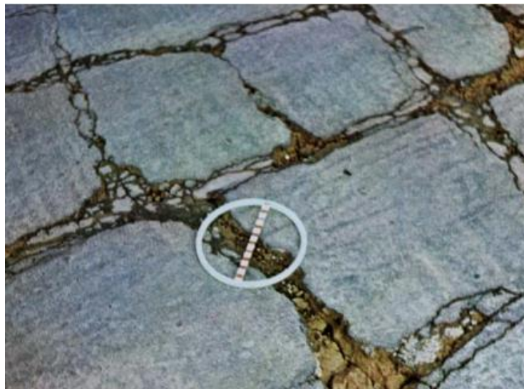
Figura 13 - Trinca interligada – tipo bloco
