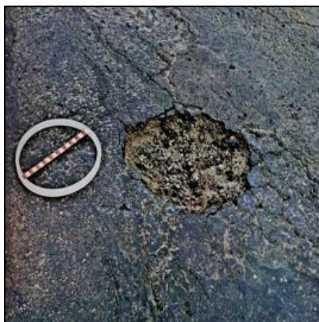
Figura 5 - Patologia, tipo buracos e painelas
