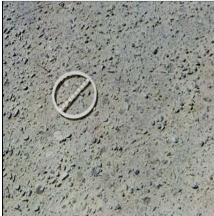
Figura 9 - Degradação da camada superficial do pavimento por desgaste
