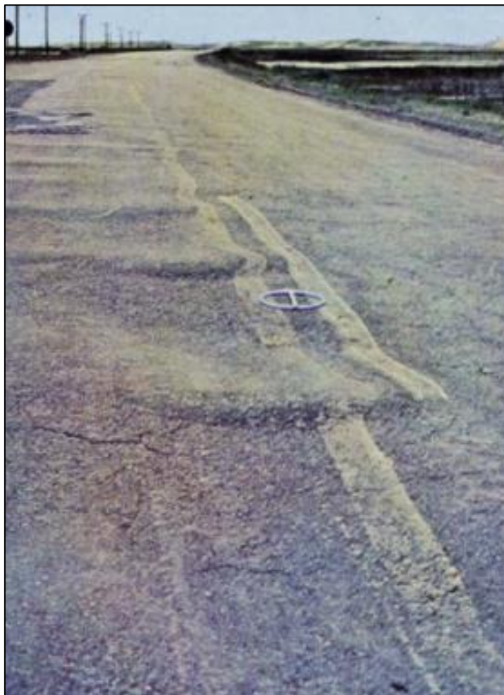
Figura 6 - Patologia do tipo Ondulação
