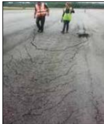
Figura 7 - escorregamento do revestimento
