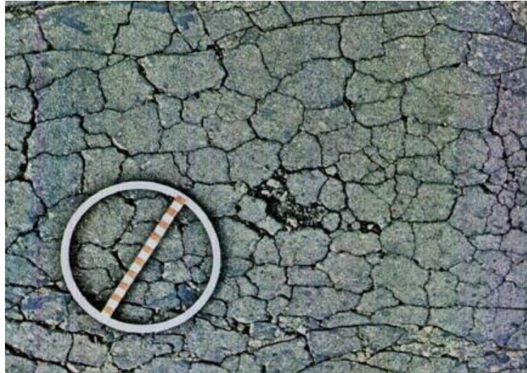
Figura 12 - trinca interligada – tipo jacaré
