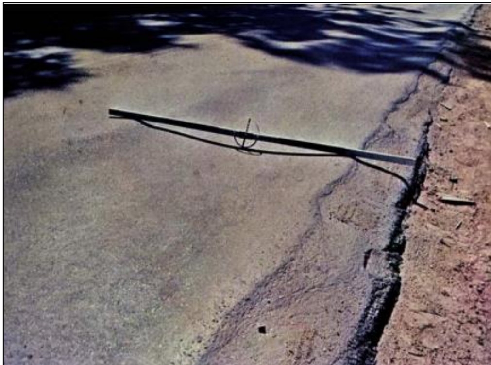
Figura 10 - Medidor de flecha de ATR apontando o defeito
