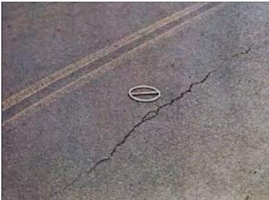
Figura 11 - Trinca isolada paralela longa
