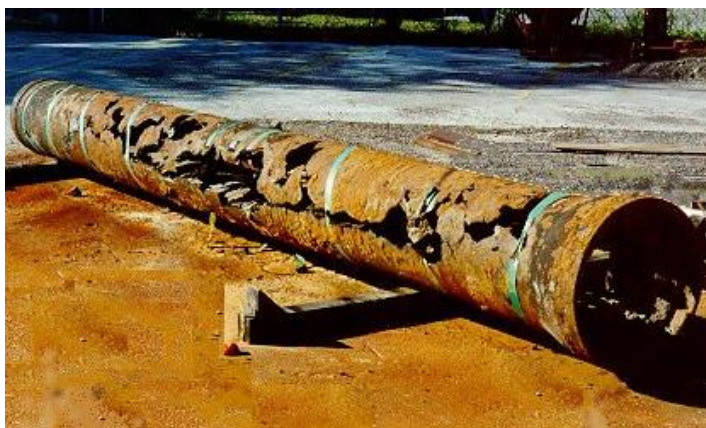
Figura 1 – Corrosão final em um duto.
