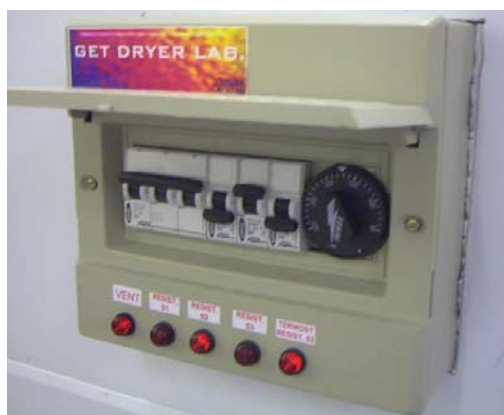
Figura 5.25-Painel elétrico para acionamento
