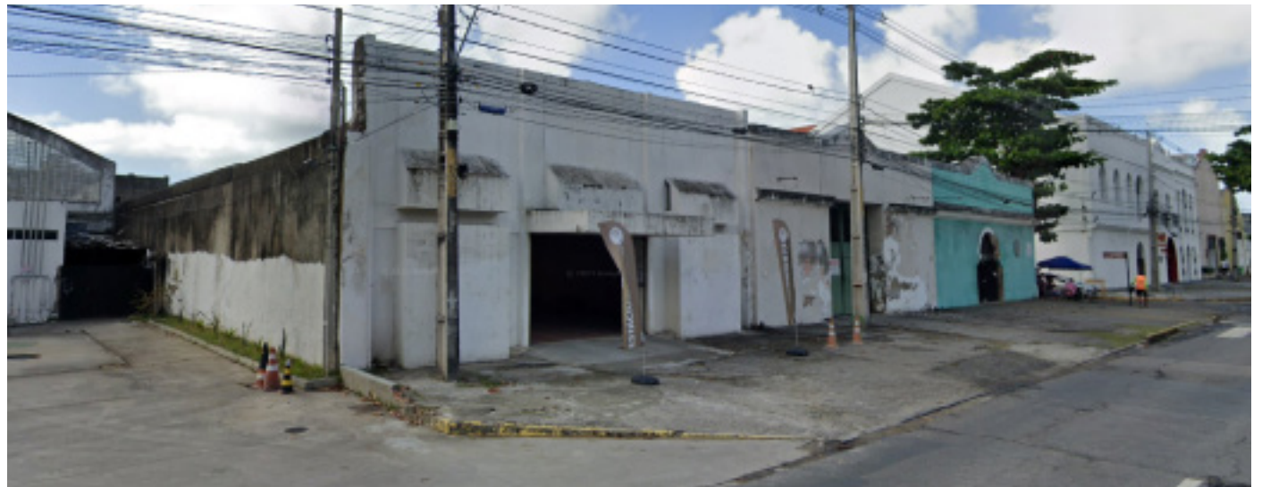
F13 - Fachada poente do armazém 539 totalmente descaracterizada.
