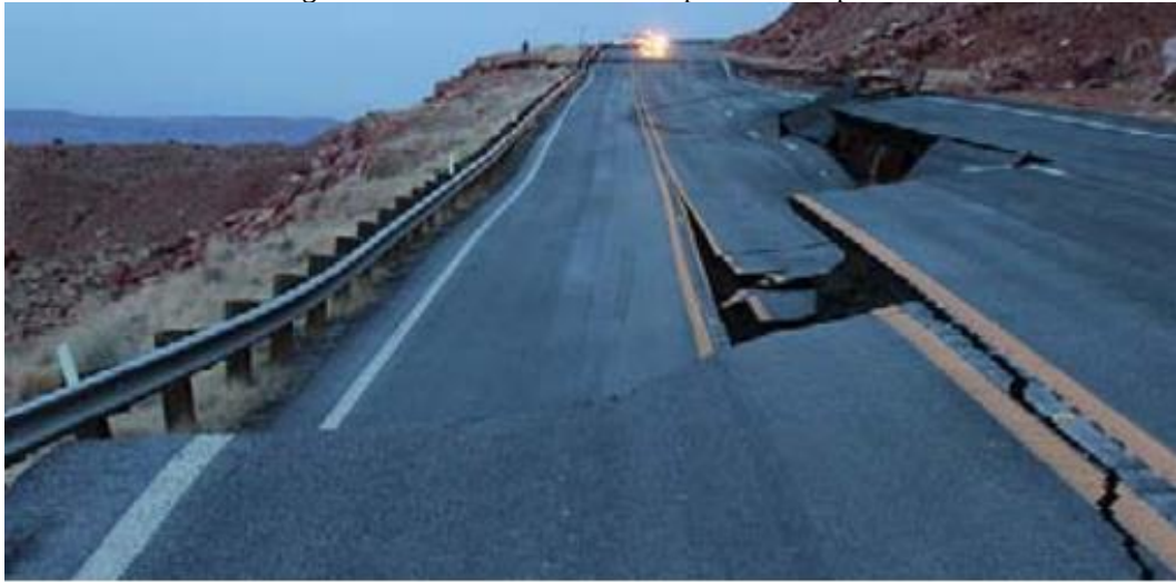
Figura 11 – Problema ocasionado por solo colapsível
