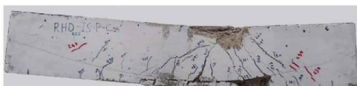
(b) Vista longitudinal na viga RHD 400 -P-C 25
