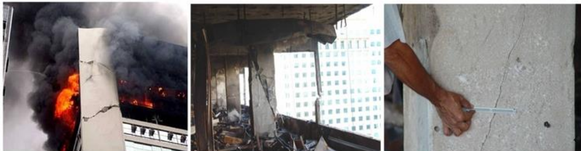
Figura 2 – Pilares e vigas de concreto armado comprometidos após incêndio
