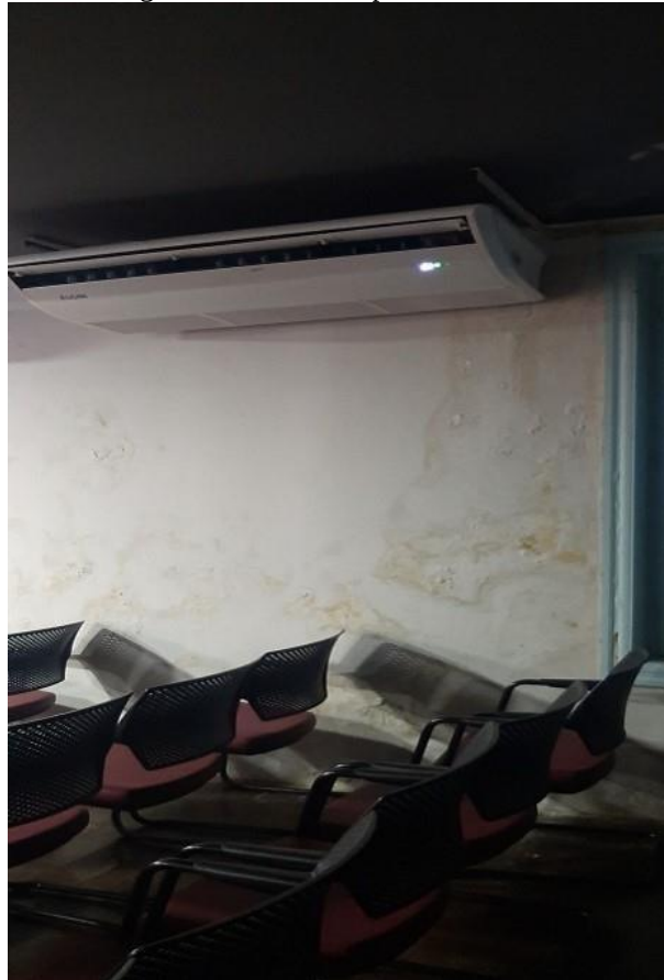
Figura 13 – Umidade presente na Sala do Piano
