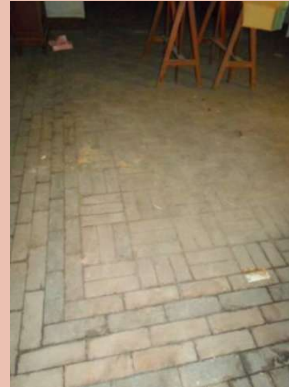
Imagem 39: Desgaste do piso em madeira do térreo.
