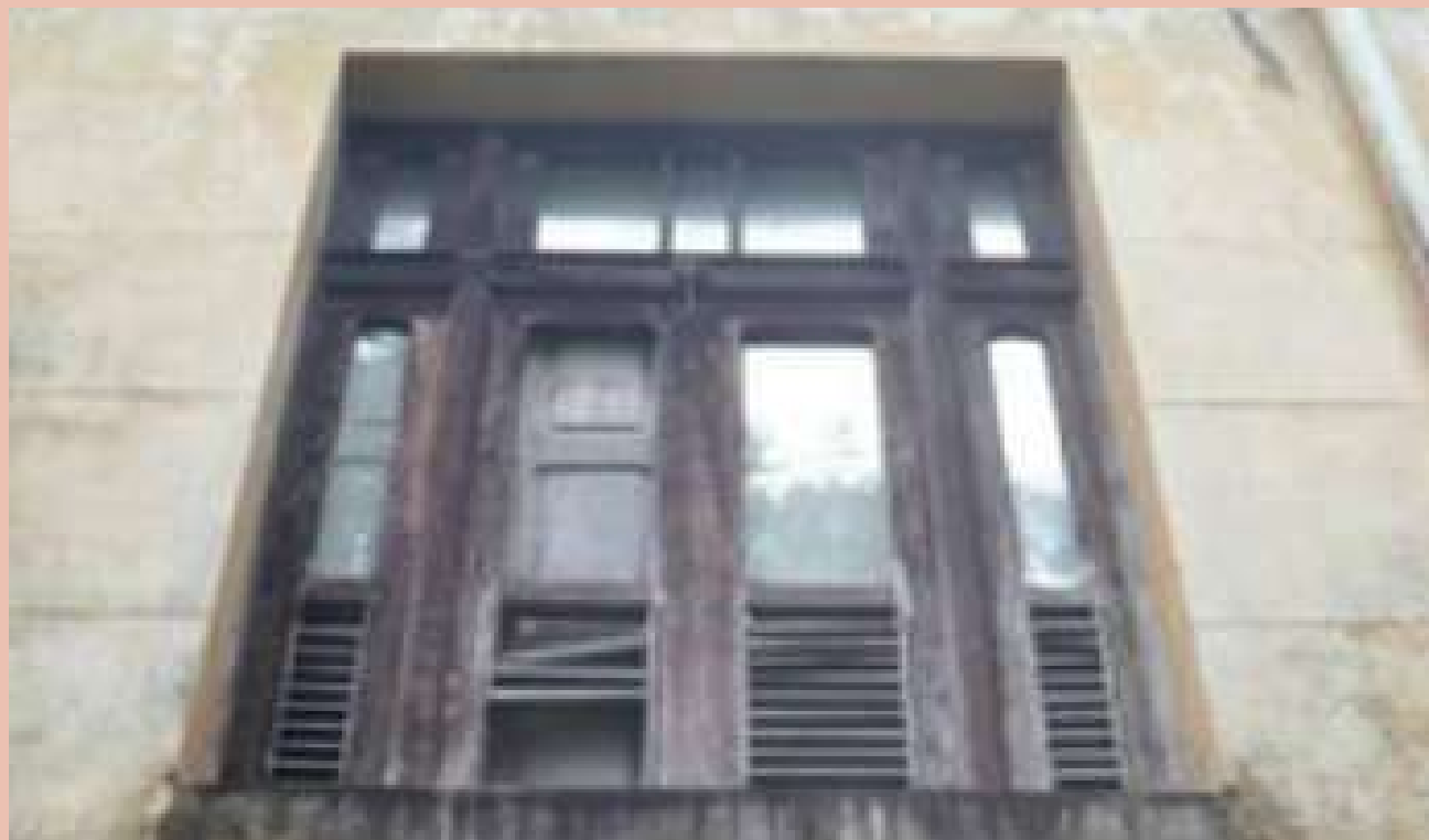
Imagem 41: Degradação da esquadria em madeira e vedada com venezianas e vidro.
