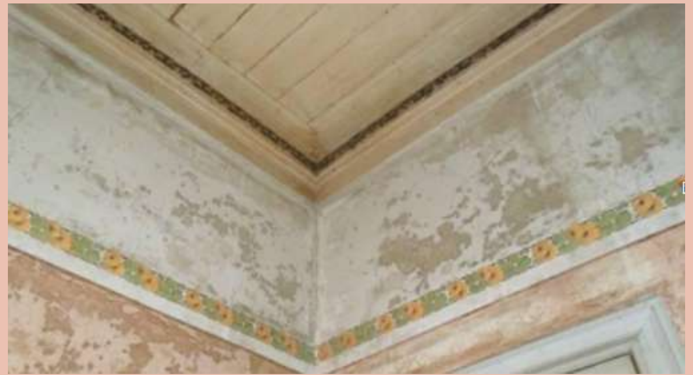
Imagem 43: Detalhe do forro em lambri e pintura decorativa em estado de degradação.
