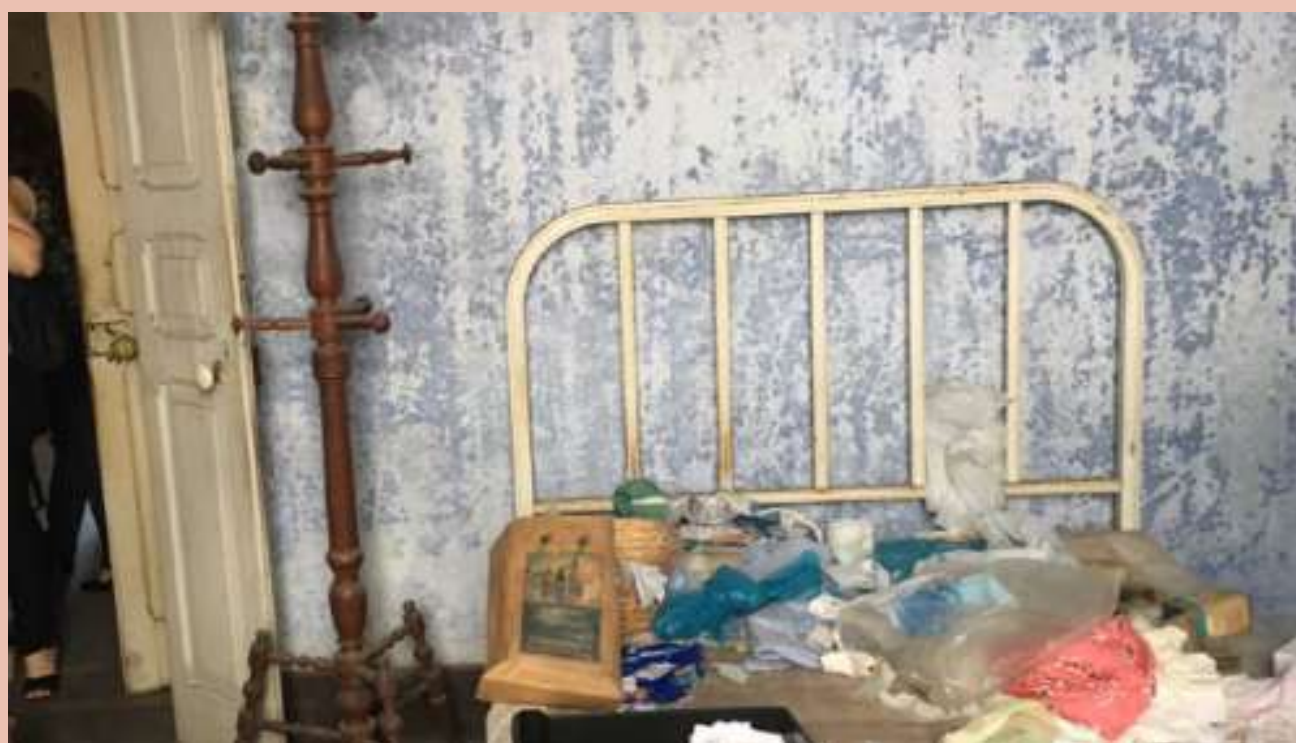
Imagem 42: Descascamento de pintura e proliferação de mofo e lixo no interior do imóvel.
