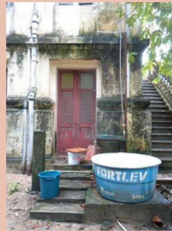
Imagem 40: Elemento espúrio na fachada posterior (leste)
