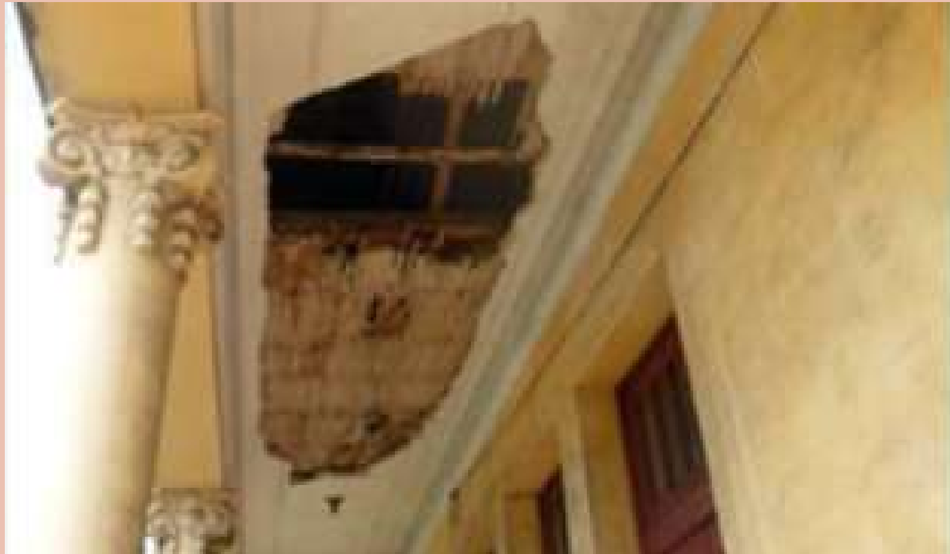
Imagem 37: Desabamento do forro.
