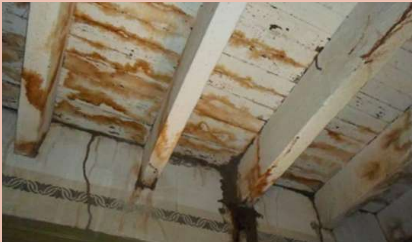
Imagem 38: Aparecimento de ferrugem e infiltrações no forro.
