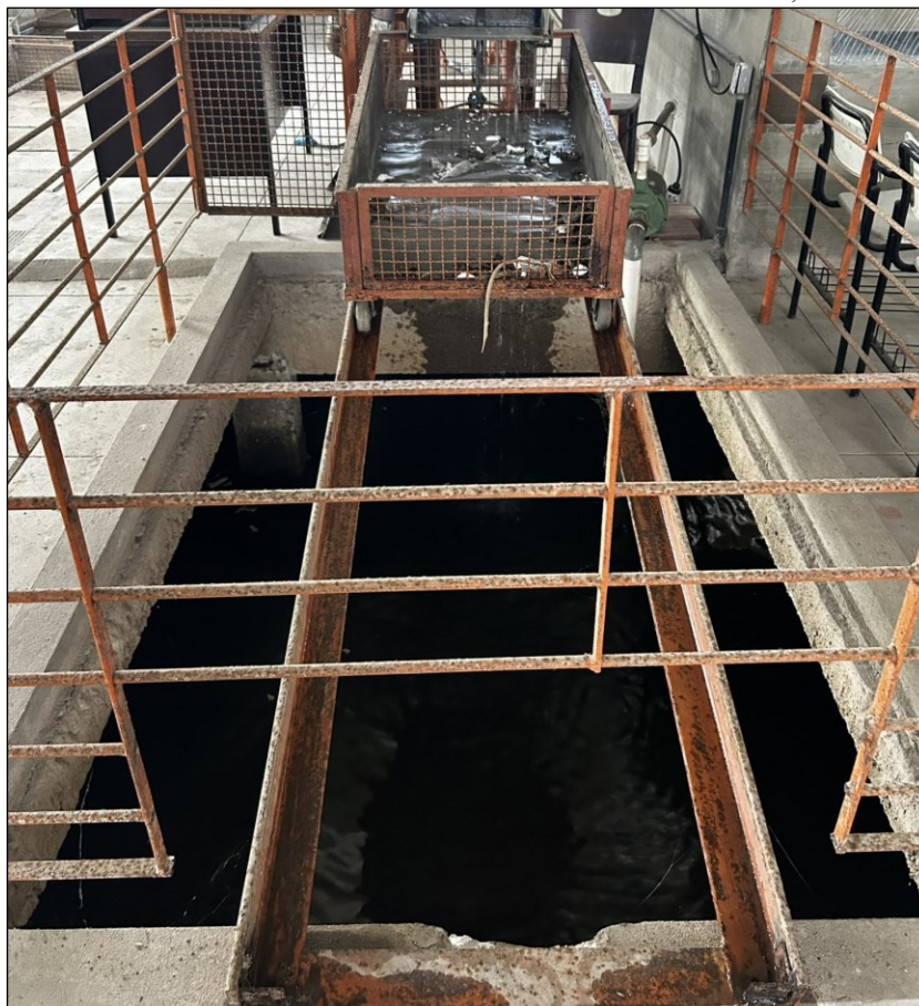
Figura 27 – Reservatório subterrâneo do Laboratório de Hidráulica da UFPE, alimentador do canal
