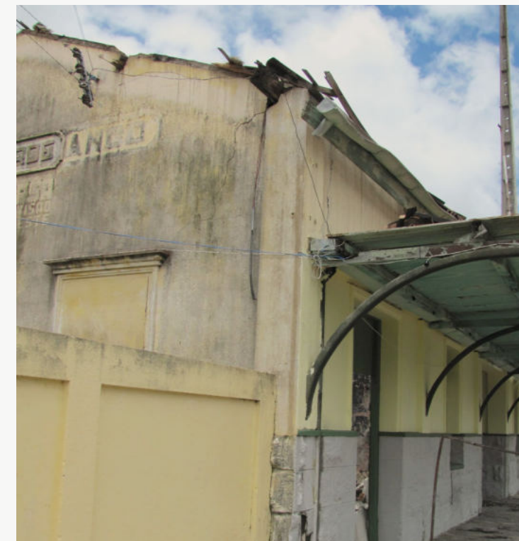
Figura 11 - Estação da cultura em 2012, após o incêndio
