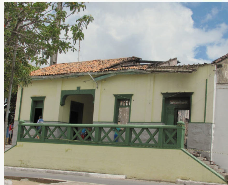
Figura 10 - Estação da cultura em 2012, após o incêndio
