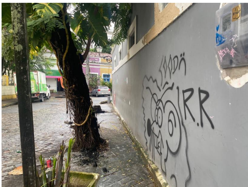
Figura 19: Equipamento urbano interferindo na estrutura física do passeio. Fonte: Costa, 2023.
