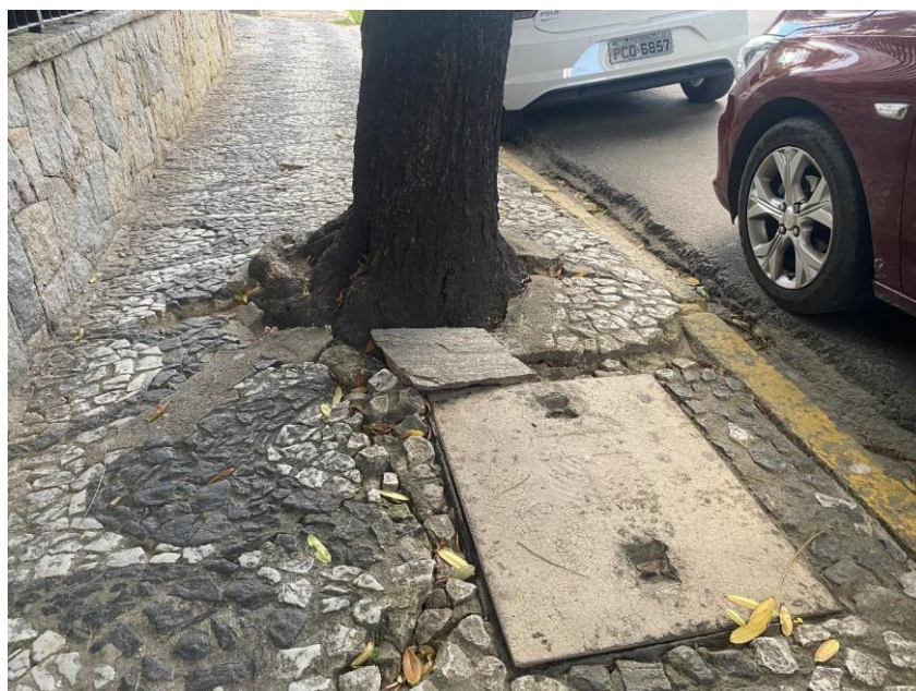
Figura 17: Desníveis no passeio causados por equipamentos urbanos. Fonte: Costa, 2023.
