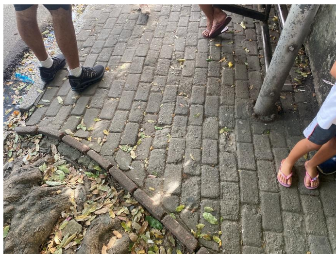
Figura 21: Parada de ônibus e árvore interferindo na largura do passeio. Fonte: Costa, 2023.
