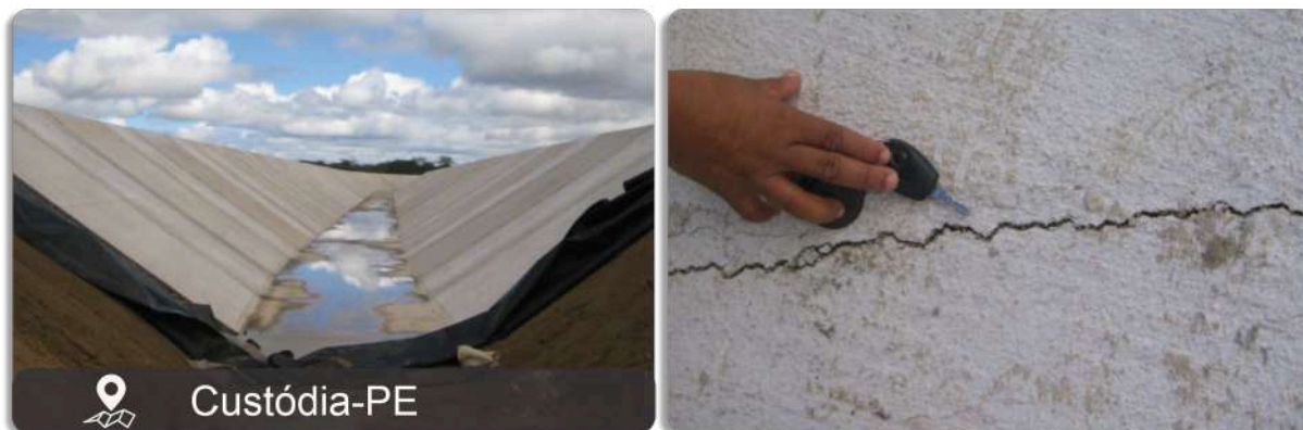
Figura 13 - Canal de irrigação com fundação apoiada sobre solo colapsível.
