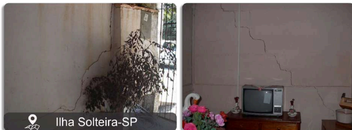
Figura 14 - Patologias nas edificações residenciais da área urbana do município de Ilha Solteira-SP.
