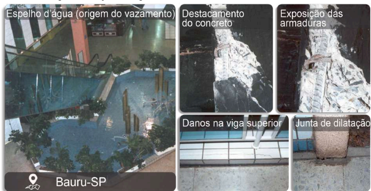
Figura 18 - Espelho de água e os danos causados no condomínio comercial.
