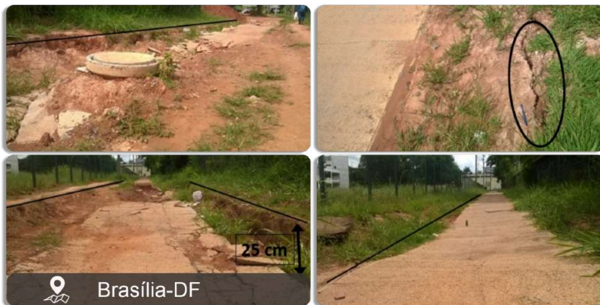
Figura 17 - Desníveis e craqueamento decorrentes do colapso do solo por infiltração de água.
