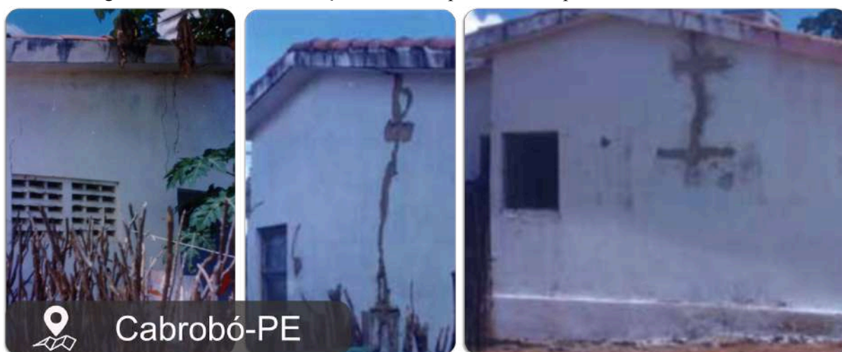
Figura 25 - Danos em edificações causados pelos solos expansivos de Cabrobó-PE.
