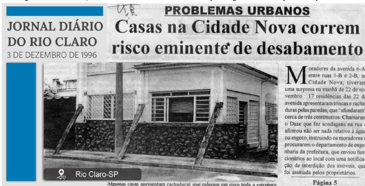
Figura 19 - Edificação residencial escorada devido às patologias causadas pelo colapso do solo.
