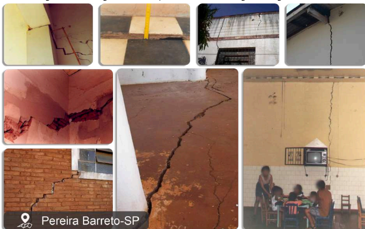
Figura 16 - Patologias nas edificações localizadas às margens do lago Três Irmãos.
