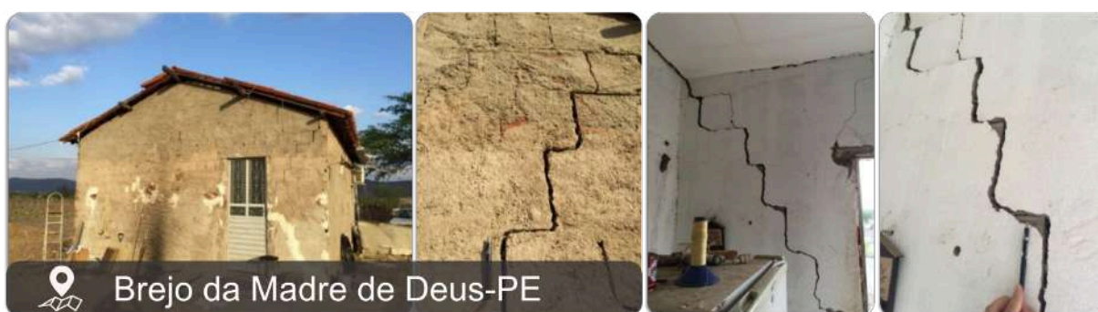
Figura 27 - Danos às estruturas dos imóveis rurais localizados no município de Brejo da Madre de Deus-PE.
