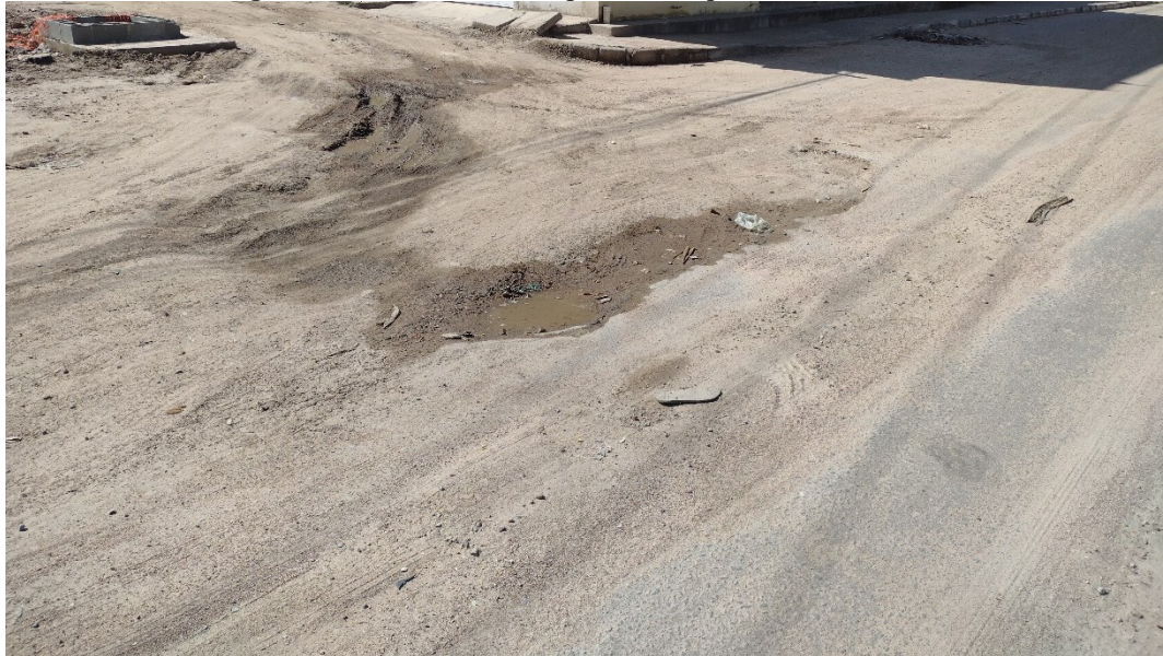
Figura 14 – Material terroso presente no pavimento analisado
