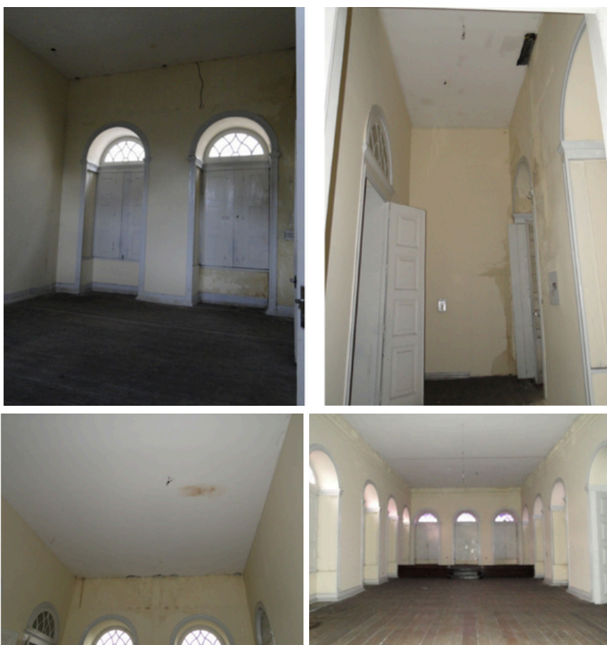
F.53,54,55 e 56 - Vista interna dos forros descaracterizados e em gesso acartonado, provavelmente inseridos na versão da CASACOR Pernambuco em 2008. Fonte: Passos, 2014
