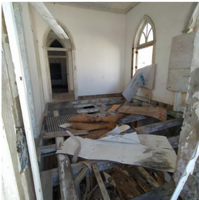
F.118 - Situação atual da Casa Julieta, registro de Janeiro de 2023. Fonte: CCM Elefante de Olinda
