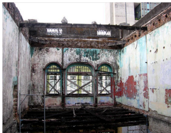
F.61 - Vista interna de um ambiente no ultimo pavimento. Visível a ausência do telhado. Fonte: PedroValadares, 2008/Flickr
