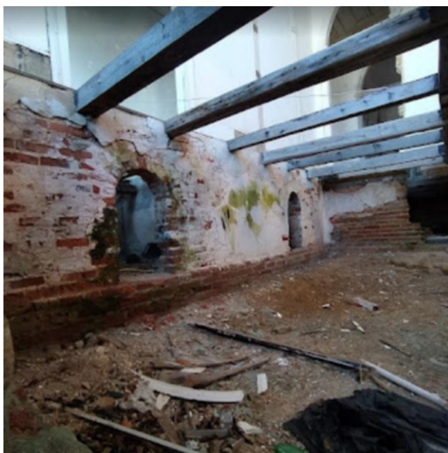
F.119 - Situação atual da Casa Julieta, registro de Janeiro de 2023. Fonte: CCM Elefante de Olinda
