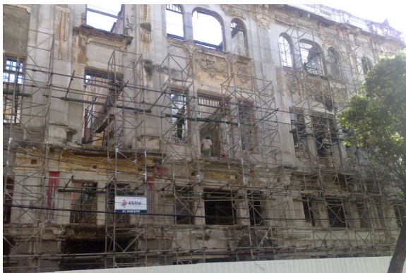
F.60 - Foto do Edifício Chateclair em estado de completo abandono, por volta de 2008. Fonte: Bruno Nogueira, 2008/Flickr
