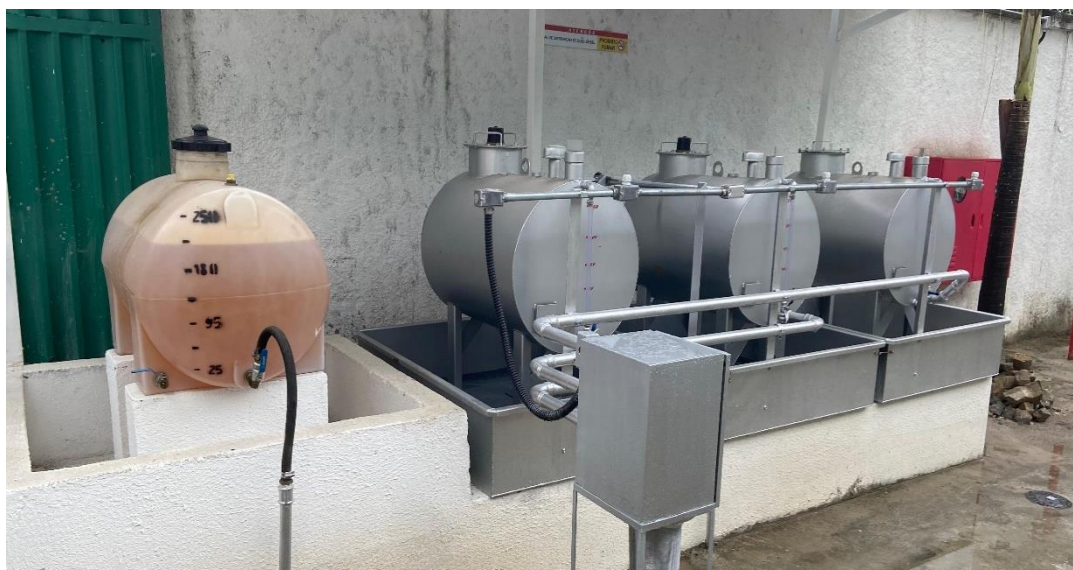
Figura 23 - Tanque de armazenamento de óleo diesel
