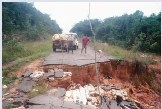
Trecho da rodovia com uma ponte rompida
