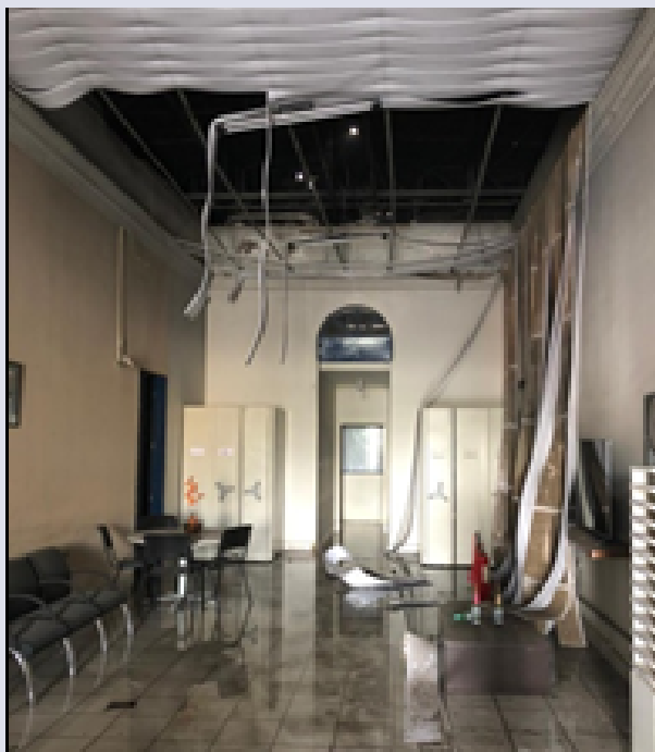
Resultado do incêndio no prédio administrativo do CAV
