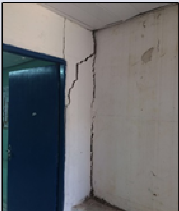
Detalhe do dano causado ao prédio Anexo
