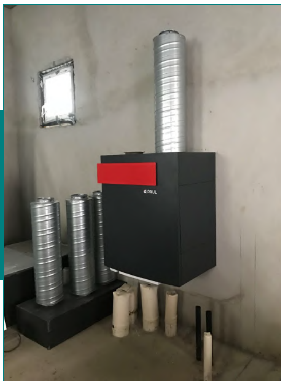
Imagem 19: Equipamento Sistema de Ventilação.
