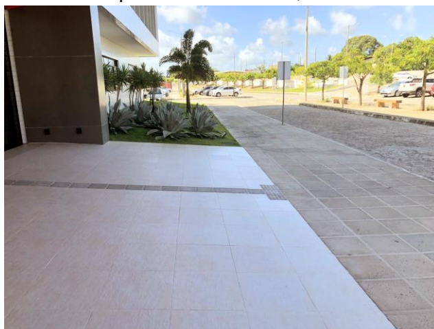
Figura 34 - Piso tátil na rampa do Bloco Central, sem continuidade na calçada
