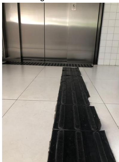
Figura 35 - Piso tátil desgastado conduzindo até o elevador
