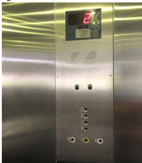
Figura 23 - Painele interno do elevador
