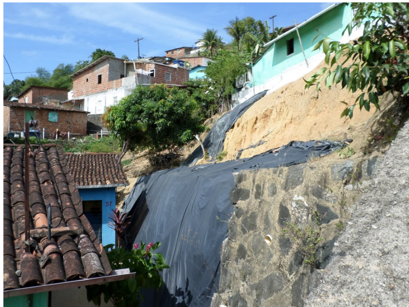
Figura 19 – Encosta danificada com muro de arrimo no bairro do Passarinho, Recife-PE
