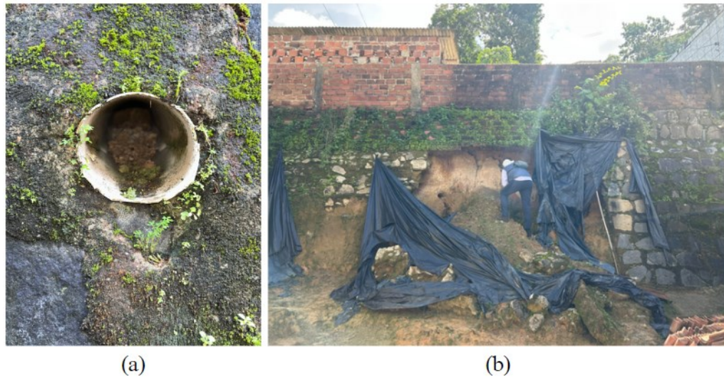
Figura 18 – Patologias em muros de arrimo no bairro do Passarinho, Recife-PE
