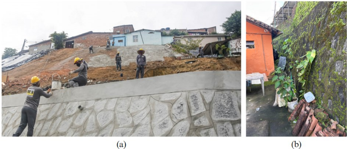
Figura 17 – Muros de concreto ciclópico nos bairros de (a) Linha do Tiro e (b) Passarinho na cidade do Recife-PE
