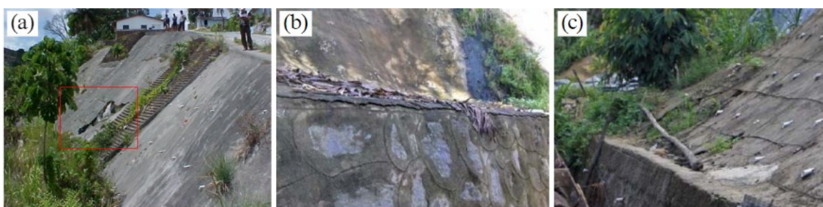
Figura 9 – Tela argamassada danificada nos municípios de (a) Camaragibe e (b) (c) Cabo de Santo Agostinho
