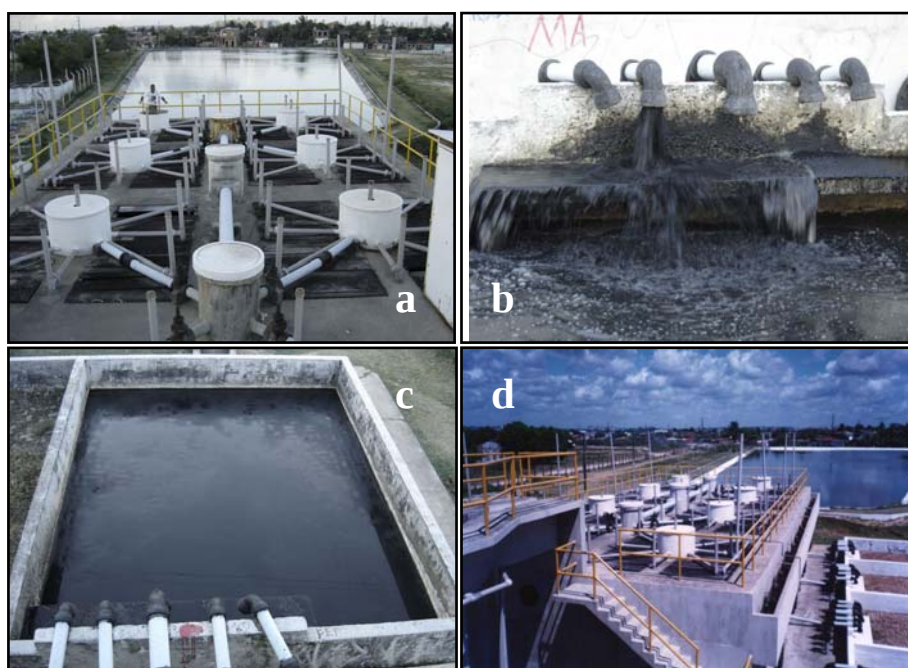
Figura 4.1. Reator UASB. a) Parte superior e ao fundo a lagoa de tratamento. b) Tubulações de coleta e descarga de lodo. c) Leito de secagem de lodo. d) Vista lateral do reator UASB
