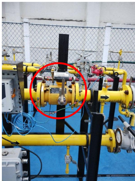
Figura 16: Transmissão de vazão de gás da Copergás.
