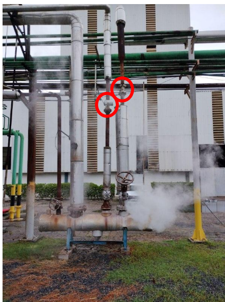
Figura 17: Tubulação de distribuição de vapor.
