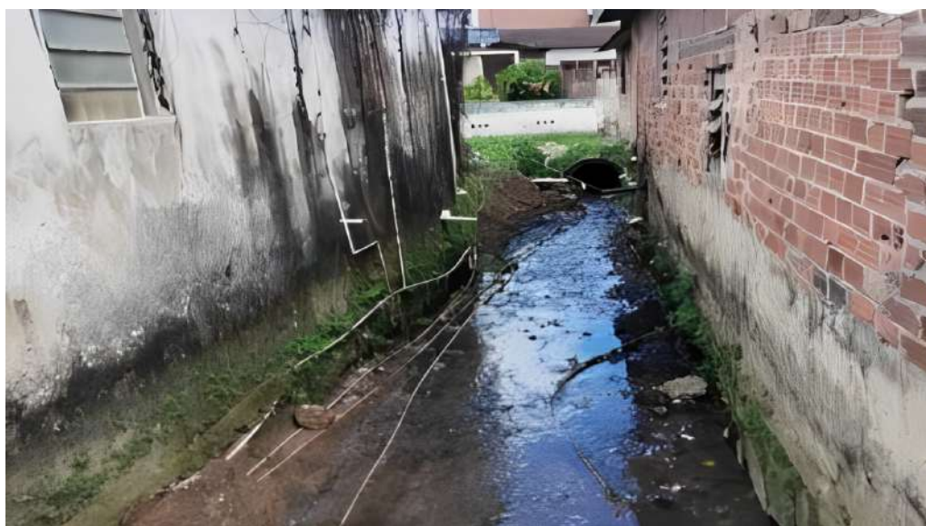
Figura 09- Sistema de drenagem precário
