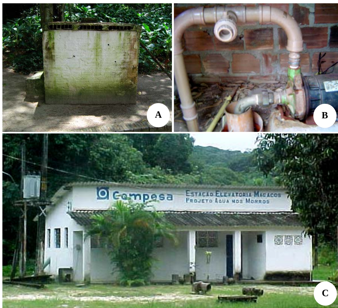
Figura 34. Consumo do recurso presente no aquífero Beberibe Inferior. A - Instalação de Poços Artesianos. Vista geral da Casa da Bomba; B - Poço de captação de água para abastecimento; C - Estação Elevatório Macacos responsável por elevar o nível das águas capadas do Vale do Prata, sobre responsabilidade da COMPESA. Fotos: Aretuza Brito Ramos, 2006.
