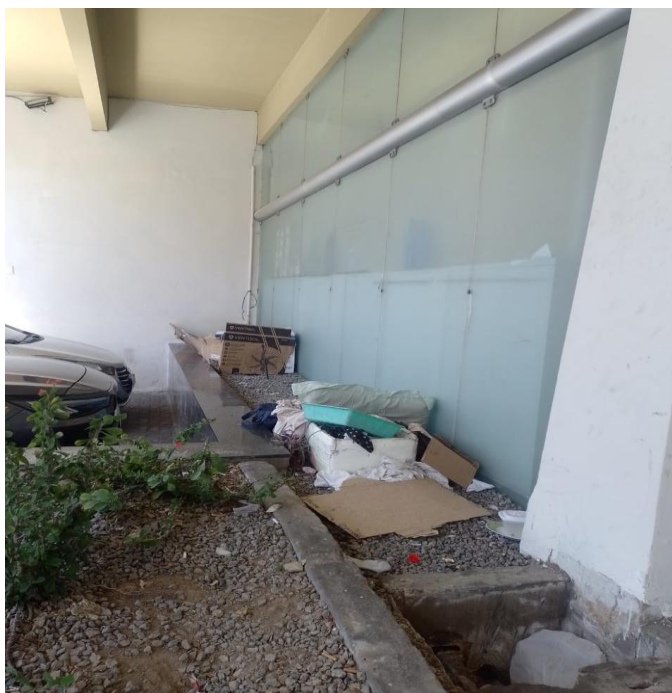
Figura 10 – Local utilizado como abrigo e ponto de dormir por várias pessoas em situação de rua
