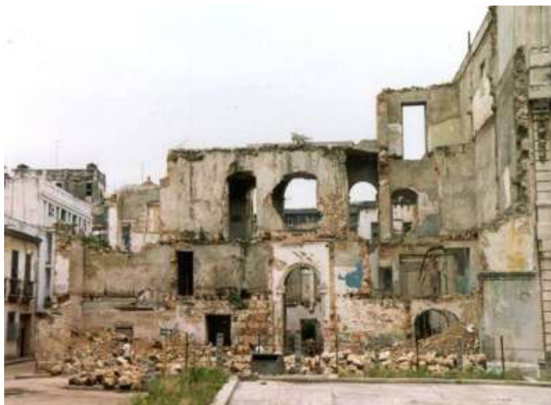
Imagen 109- Ruinas del Edificio Santo Ángel.
