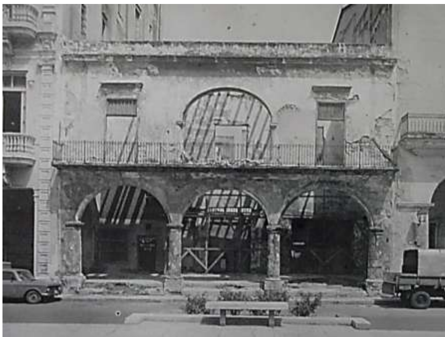
Imagen 82- Estado de deterioro de la Casa de Beatriz Pérez Borroto (Mercaderes No. 307) en 1983.
