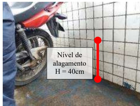
(c) Marca de alagamento no imóvel observado. Fonte: A Autora (2019).
