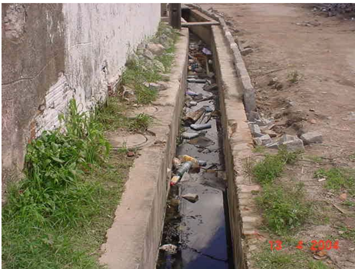
Foto 7: Resíduos sólidos lançados no sistema de drenagem na Mangueira
