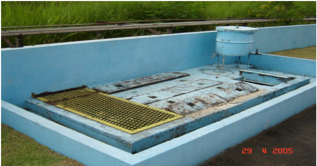
Foto4.5 – Separador de Óleo da Central de Resíduos da Petroflex Cabo (GADÊLHA, 2005)
