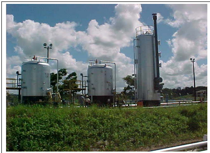
Figura 10 Torres de separação água/óleo na Estação Coletora Jordão
