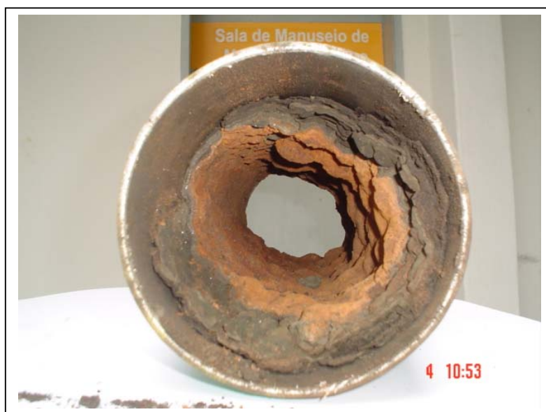
Figura 15 Tubulação de água produzida retirada da Estação Coletora Sítio Novo (amostras 45, 46 e 47)
